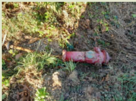
Borne incendie arrachée
